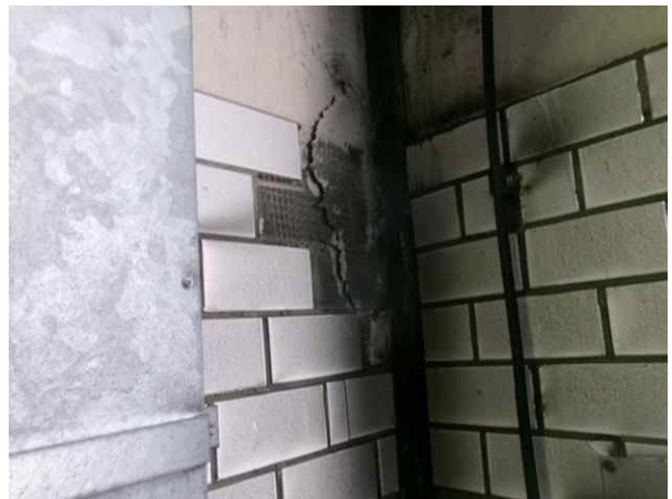
본선 BOX구간 벽체 S725 파손, 타일탈락
