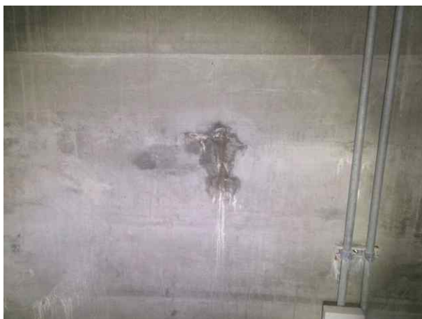
공기정화시설#2 환기탑 B3 백태
