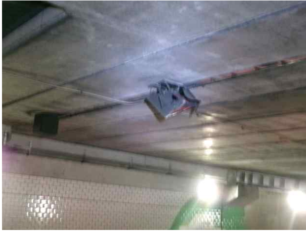
본선 S304 신호기 파손
