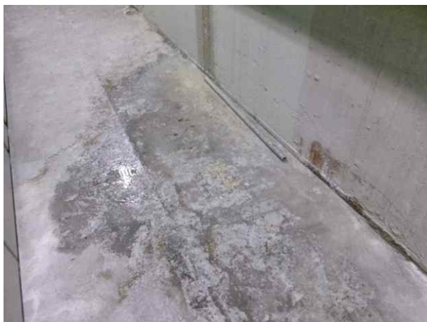
RAMP-C 전기실 바닥 체수
