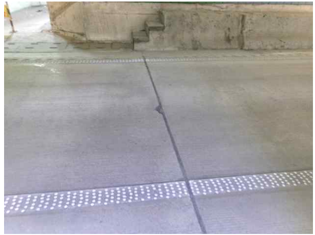
본선 포장부 S690 파손
