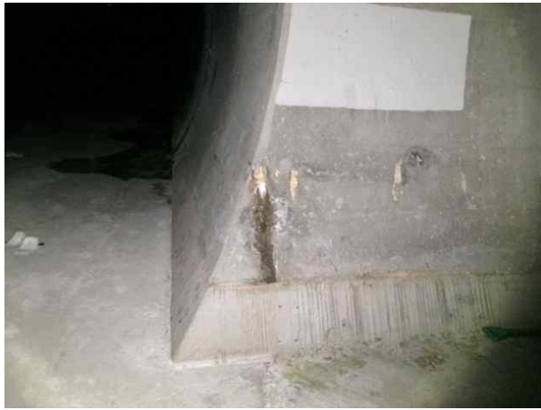
공기정화시설#2 유도강 측벽부 누수
