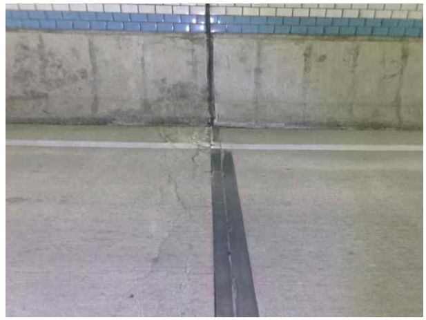
본선 포장부 S716 파손, 로드셀 파손
