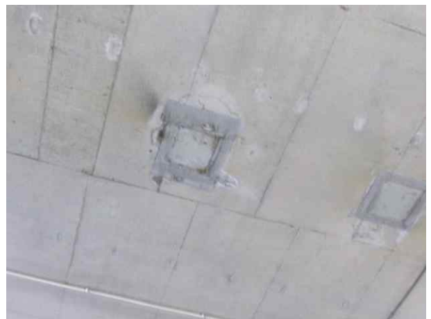
본선 BOX구간 슬래브 S717 누수(떨어짐)
