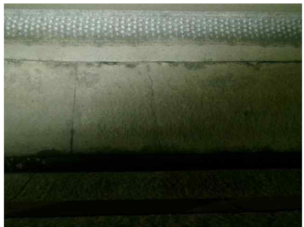
본선 포장부 S149 균열
