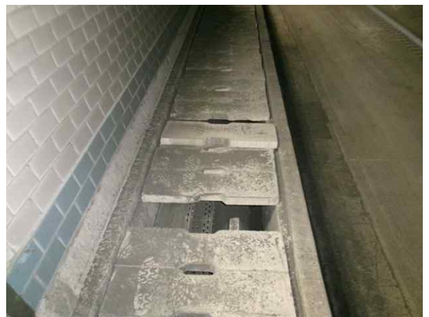
본선 공동구 S294 덮개탈락
