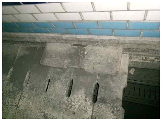
본선 공동구 S344 덮개파손
