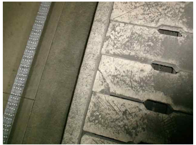
본선 공동구 S168 덮개파손
