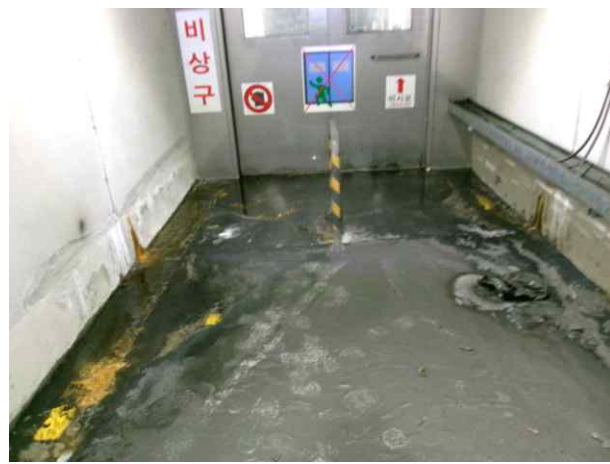
피난연락갱 S062 누수(떨어짐)
