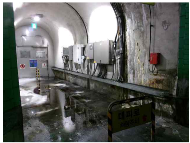
피난연락갱 S127 누수(떨어짐)
