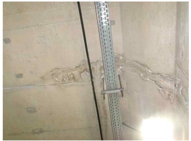
본선 BOX구간 슬래브 S716 균열부백태
