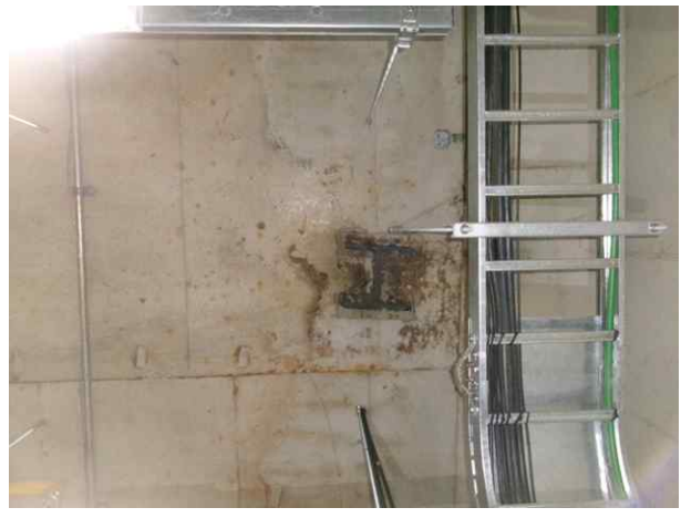
전기실 S005 천단부 철근노출
