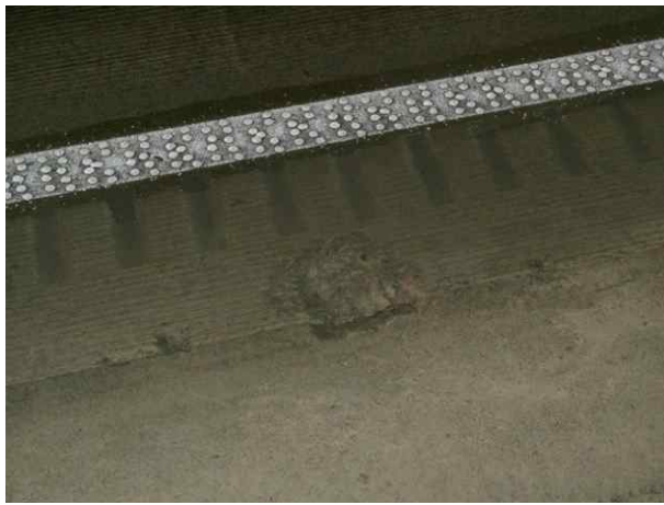
본선 포장부 S222 파손
