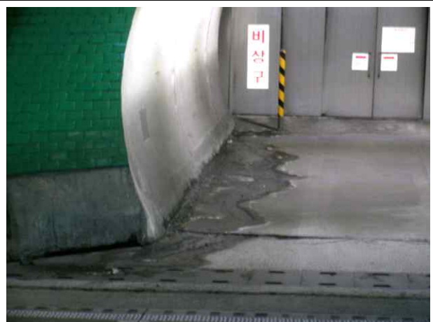
피난연락갱 S249 누수(떨어짐), 체수
