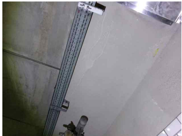
본선 NATM구간 측벽부 S710 균열( C_w=0.2\text{mm} )
