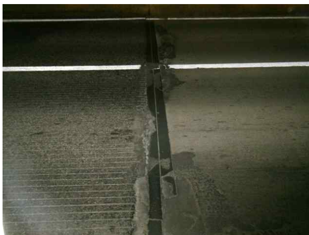
본선 포장부 S725 파손
