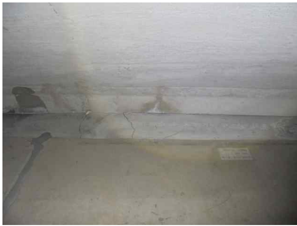
본선 NATM구간 풍도슬래브 S480 상면 파손
