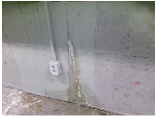
RAMP-C 전기실 측벽부 백태
