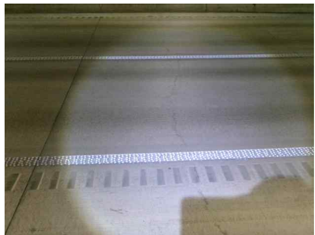
본선 포장부 S326 균열
