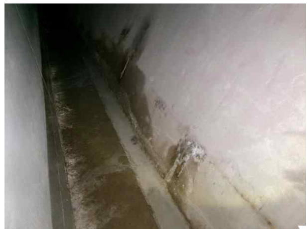
공기정화시설#2 축류팬실 측벽부 누수
