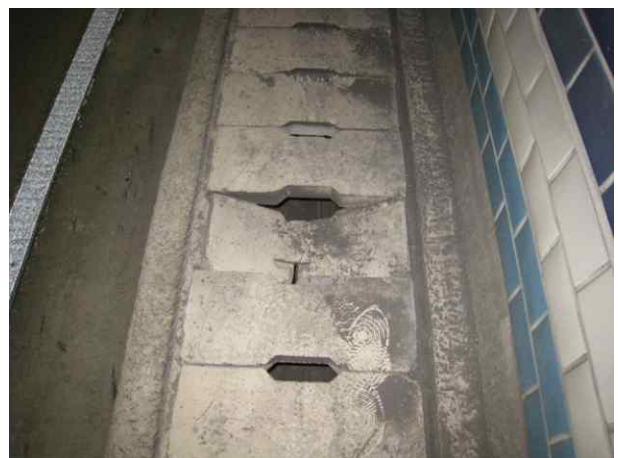
RAMP-C 공동구 S60 덮개파손
