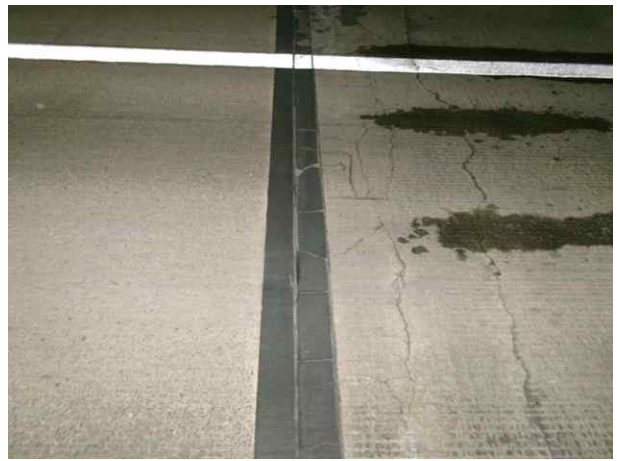
본선 포장부 S723 로드셀 파손, 망상균열
