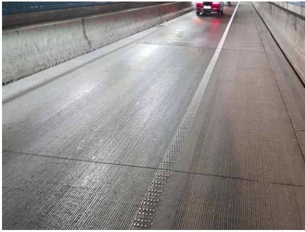
RAMP-C 포장부 S40~41 들뜸
