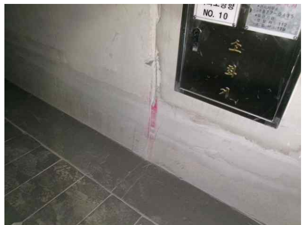
RAMP-C NATM구간 측벽부 S19 보수부 박리
