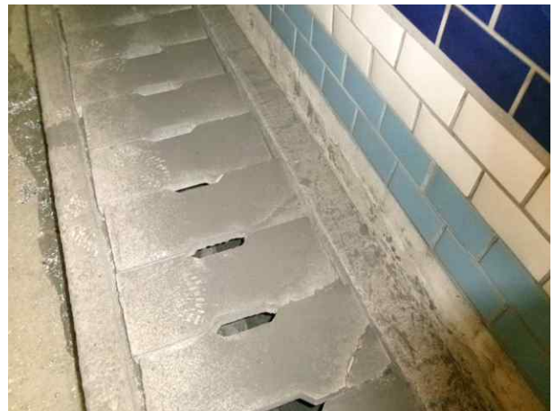
RAMP-C 공동구 S13 덮개파손
