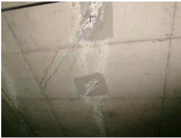
본선 BOX구간 슬래브 S002 누수(스며있음)
