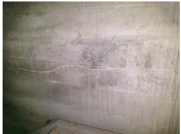
공기정화시설#2 환기탑 B3 균열(Cw=0.3mm)
