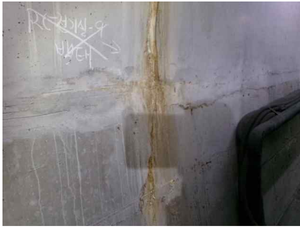
RAMP-C 전기실 측벽부 백태
