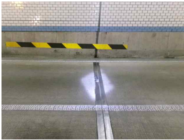
본선 포장부 S005 로드셀 파손
