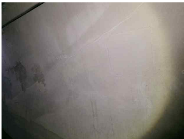
RAMP-C NATM구간 측벽부 S17 균열(Cw=0.1mm)
