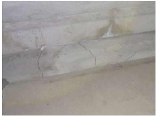
본선 NATM구간 풍도슬래브 S480 상면 파손
