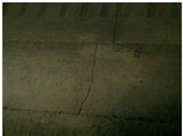
본선 포장부 S222 균열
