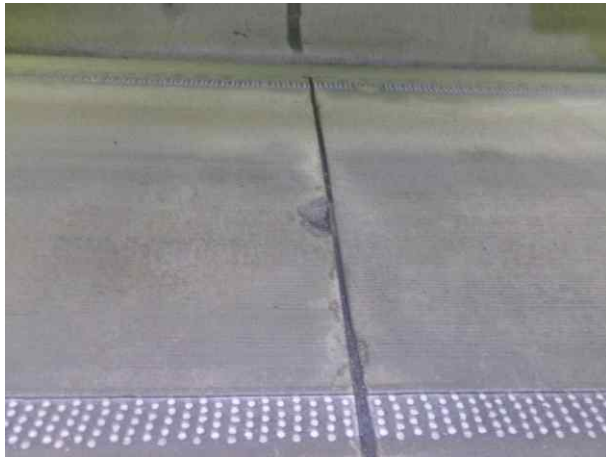
본선 포장부 S613 파손
