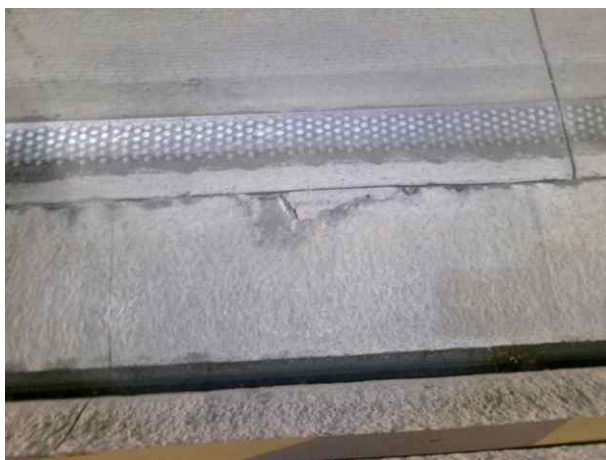
본선 포장부 S154 파손
