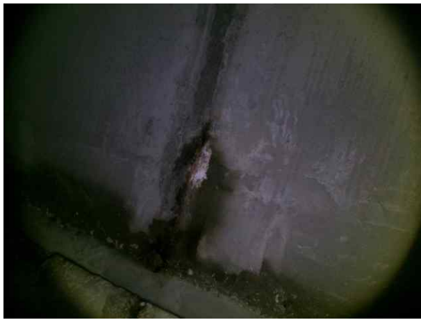
공기정화시설#2 축류팬실 측벽부 누수
