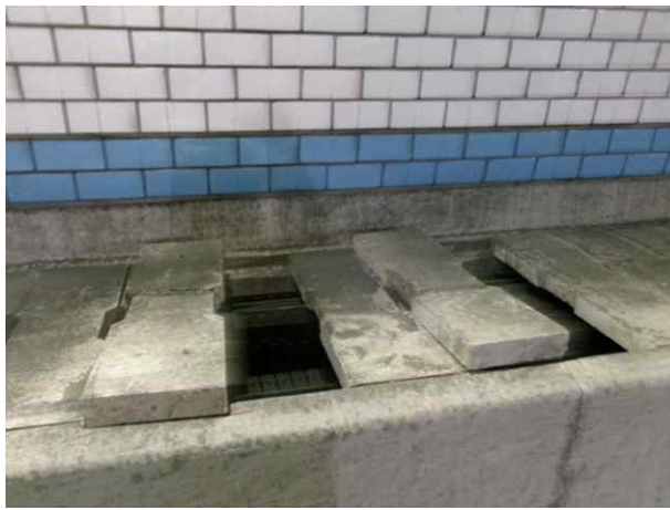
본선 공동구 S585 덮개파손
