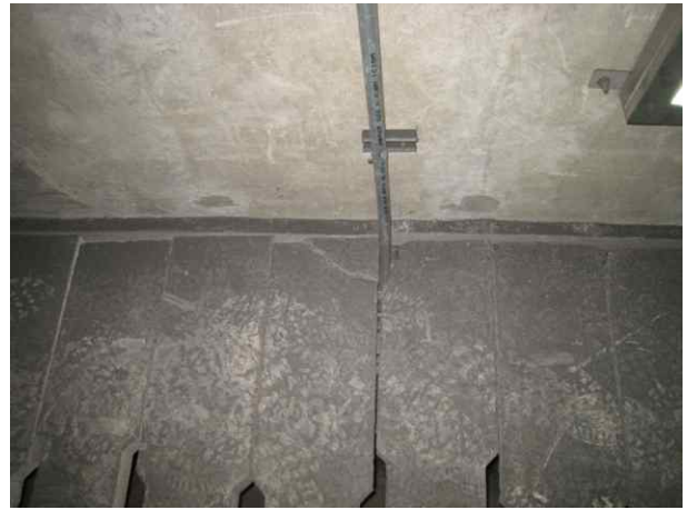
RAMP-C 공동구 S04 덮개파손
