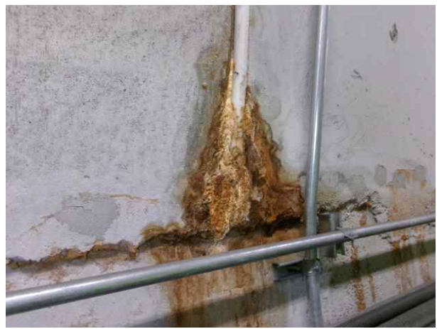
RAMP-C 전기실 측벽부 누수
