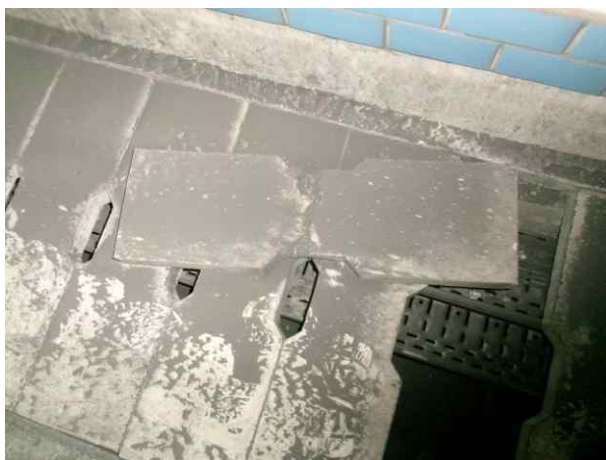
본선 공동구 S314 덮개파손
