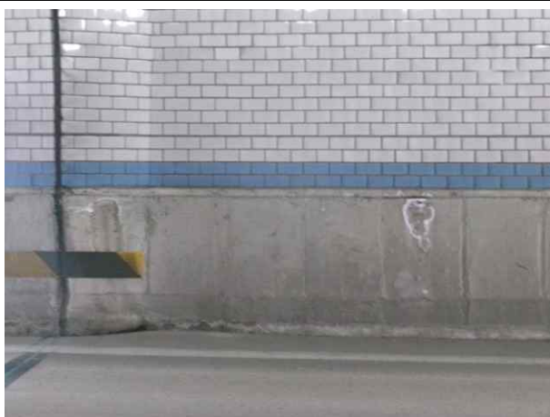
본선 공동구 S717 백태
