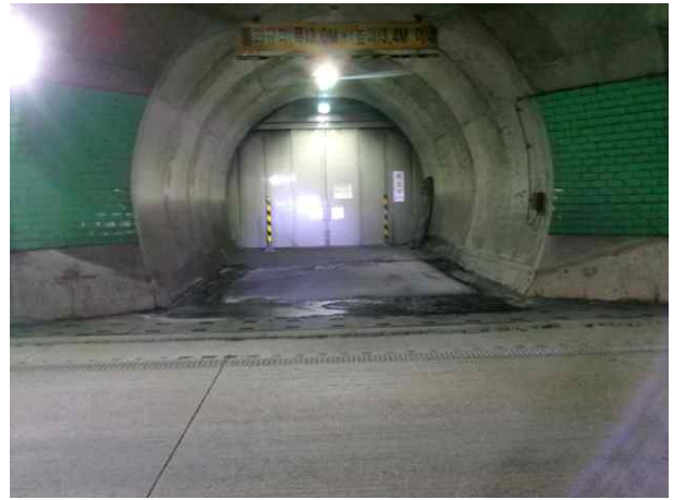
피난연락갱 S566 누수(떨어짐)
