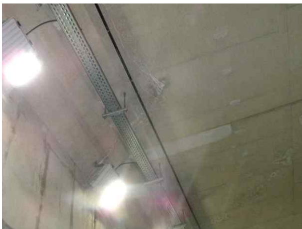
본선 BOX구간 슬래브 S717 균열부백태
