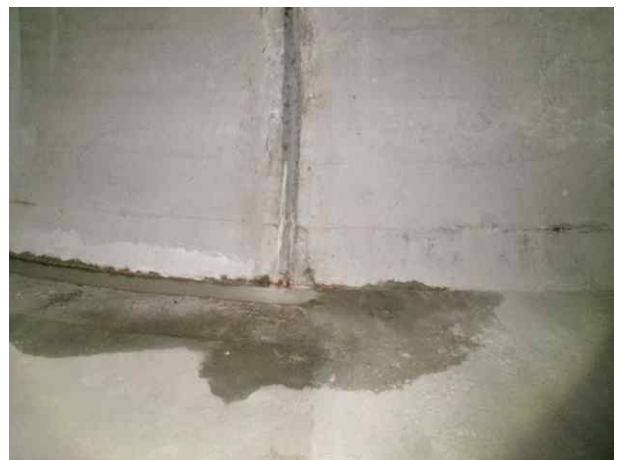
공기정화시설#2 유도갱 측벽부 누수
