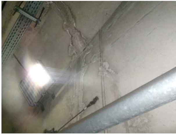
본선 BOX구간 벽체 S716 균열부백태
