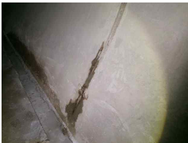
공기정화시설#2 축류팬실 측벽부 누수
