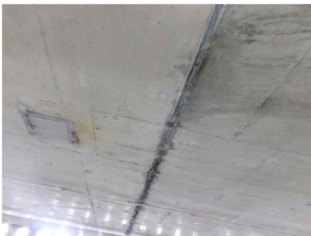
본선 BOX구간 슬래브 S721 누수(스며있음)
