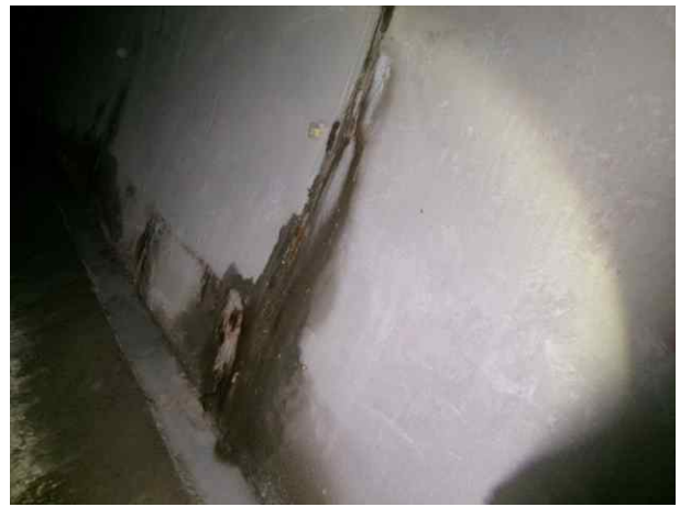
공기정화시설#2 축류팬실 측벽부 누수
