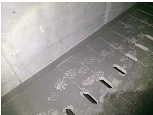
RAMP-C 공동구 S24 덮개파손
