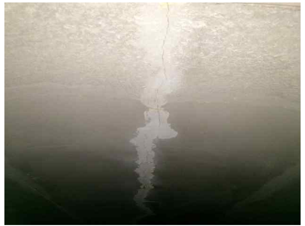
본선 NATM구간 천단부 S155 재균열( Cw=0.5mm )
