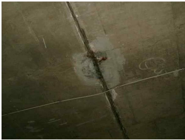
RAMP-C BOX구간 슬래브 S02 박락
