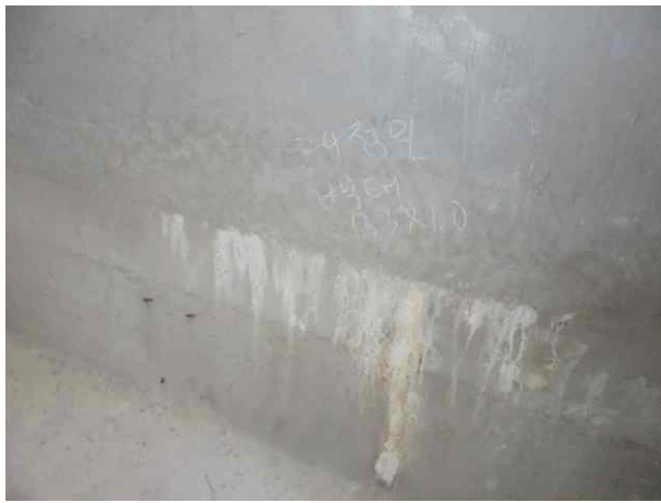
공기정화시설#2 축류팬실 측벽부 백태
