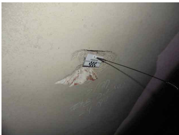
본선 NATM구간 천단부 S177 파손
