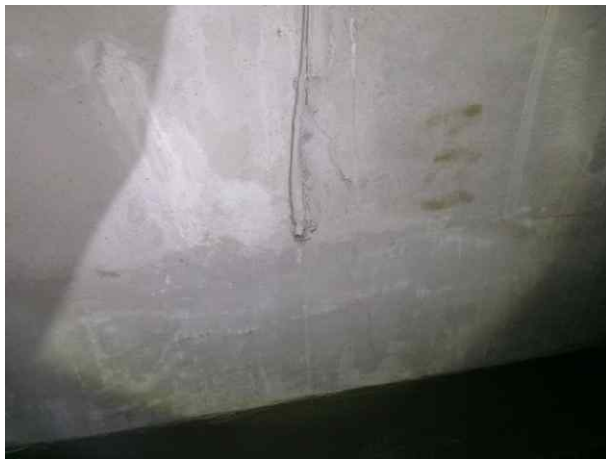
RAMP-C NATM구간 측벽부 S08 박리
