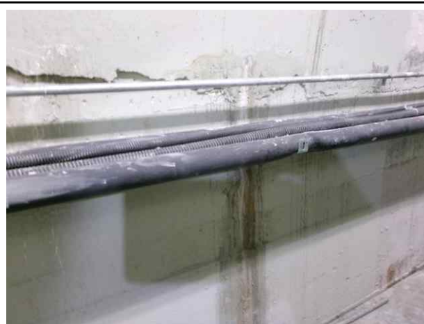
RAMP-C 전기실 측벽부 누수, 백태
