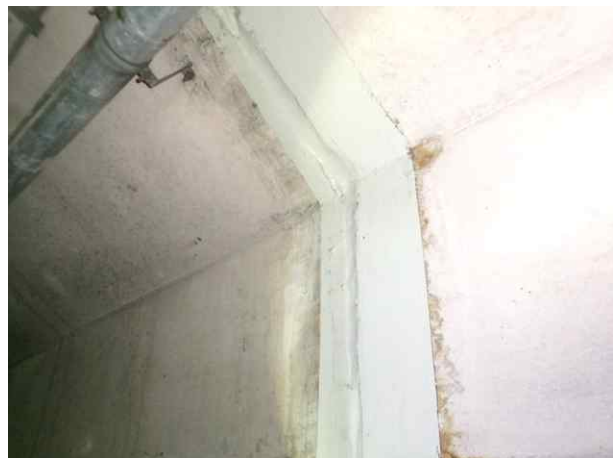
본선 NATM구간 측벽부 백태보수 양호
