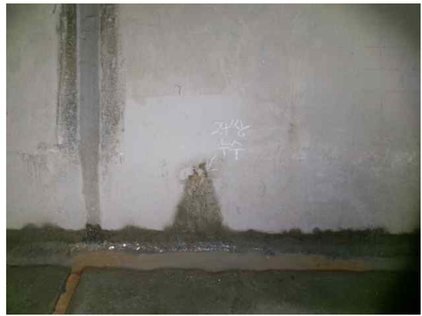
공기정화시설#2 축류팬실 측벽부 누수
