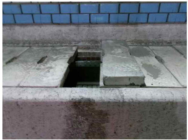
본선 공동구 S647 덮개파손
