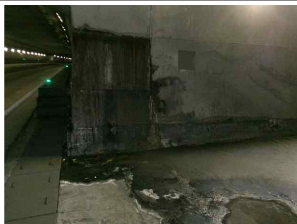
피난연락갱 S165 누수(떨어짐)
