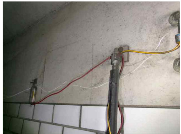
본선 NATM구간 측벽부 S267 균열( C_w=0.2\text{mm} )
