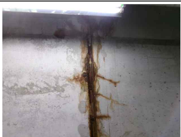
RAMP-C 전기실 측벽부 누수
