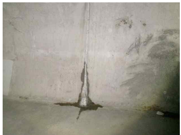
공기정화시설#2 유도갱 측벽부 누수
