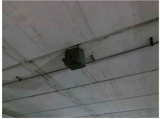
본선 S663 신호기 파손
