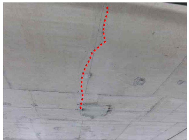
본선 BOX구간 슬래브 S723 균열(Cw=0.2mm)
