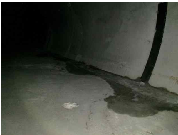
공기정화시설#2 유도갱 측벽부 누수
