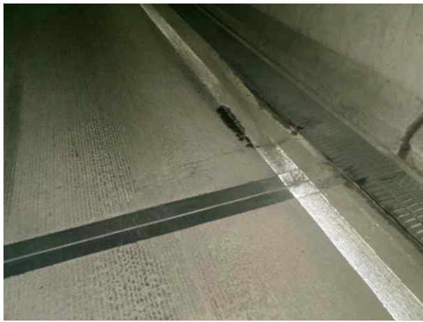
본선 포장부 S721 균열
