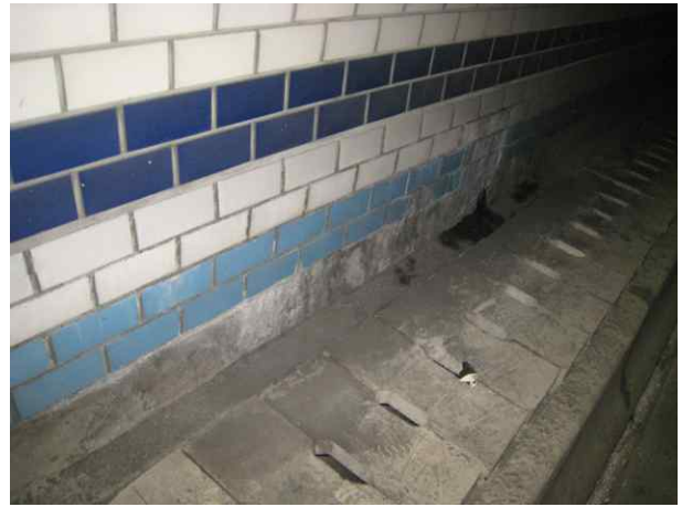
RAMP-C NATM구간 측벽부 S66 누수(떨어짐)
