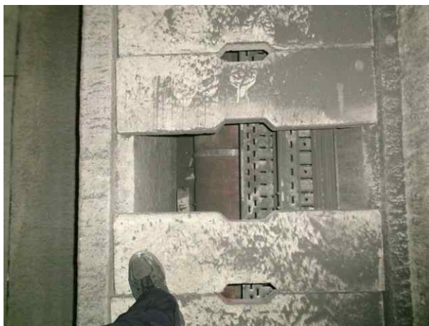
본선 공동구 S219 균열
