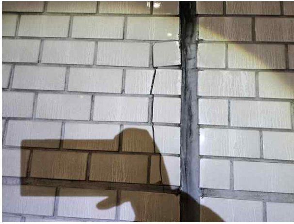
시점부 U-TYPE 옹벽 타일균열
