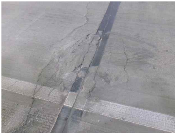
본선 포장부 S716 보수부 파손
