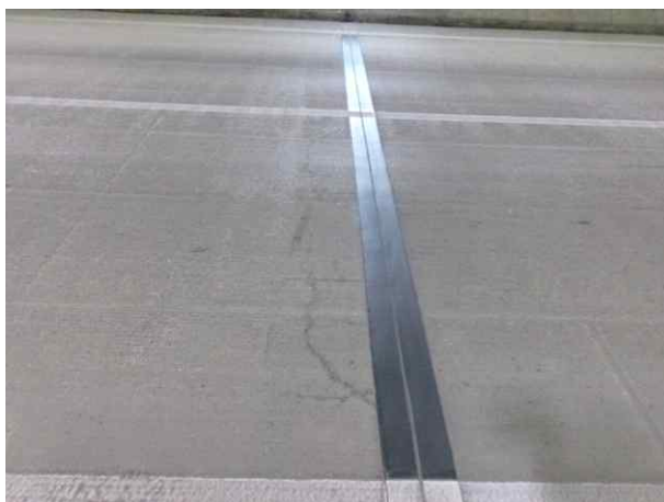
본선 포장부 S714 균열
