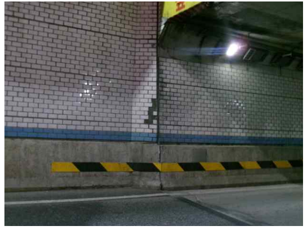
종점부 U-TYPE 옹벽 타일탈락
