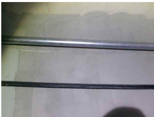
RAMP-C NATM구간 측벽부 균열부백태보수 양호
