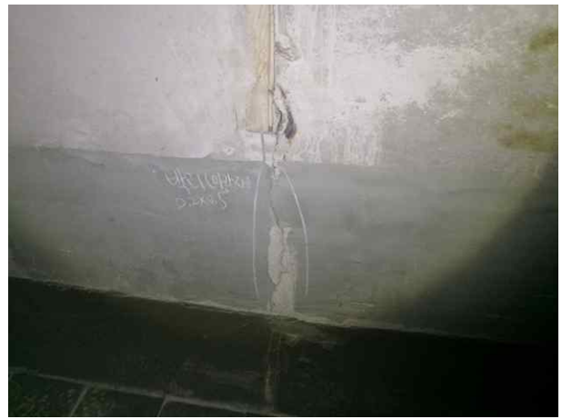
RAMP-C NATM구간 측벽부 S09 몰탈 박락
