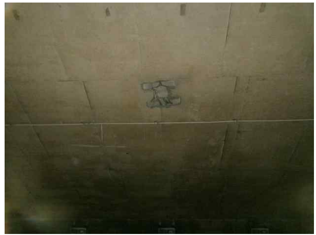
RAMP-C BOX구간 슬래브 S02 백태
