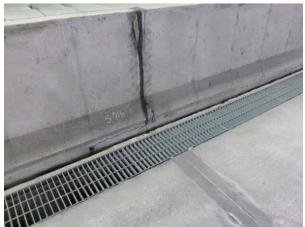
본선 공동구 S716 파손
